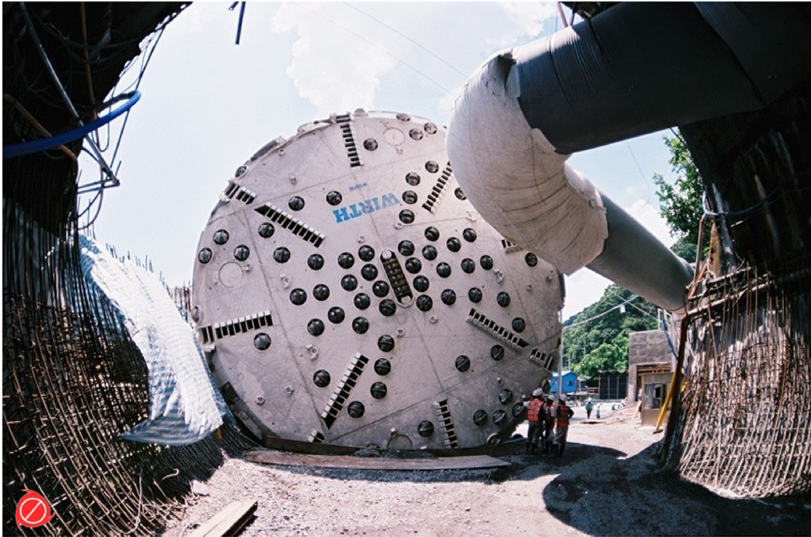
巨型隧道鑽機 (TBM) 鑽頭正面，雪山隧道主坑進洞前 (洪如江攝)
